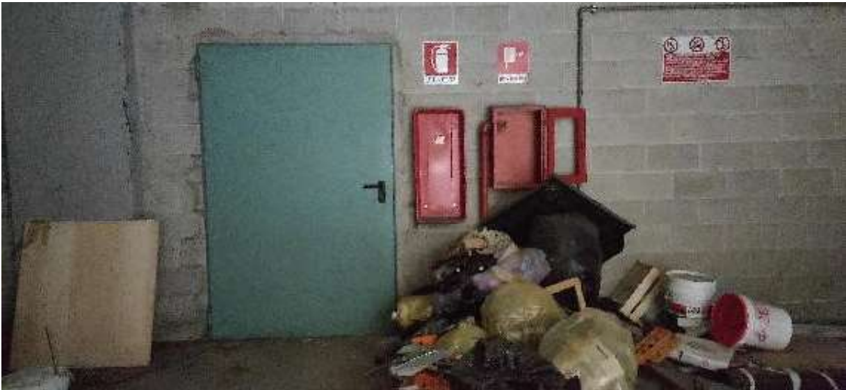
Ripresa delle dotazioni di prevenzione presenti: collegamento con l'autorimessa condominiale confinante
