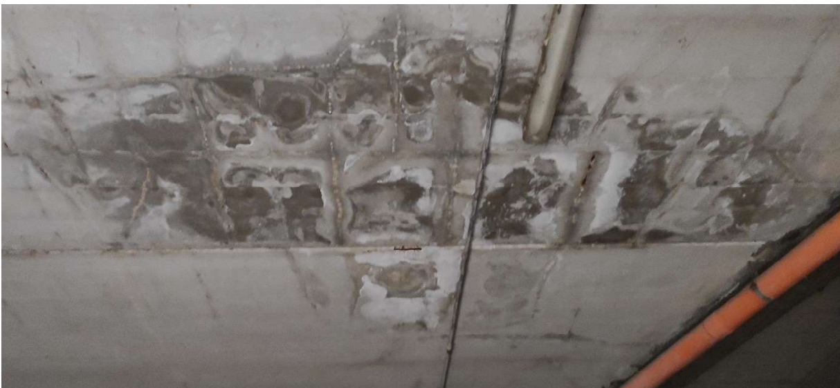
Ripresa dell'intradosso del solaio di copertura con efflorescenze dovute ad infiltrazioni di acqua piovana dall'area pubblica soprastante
