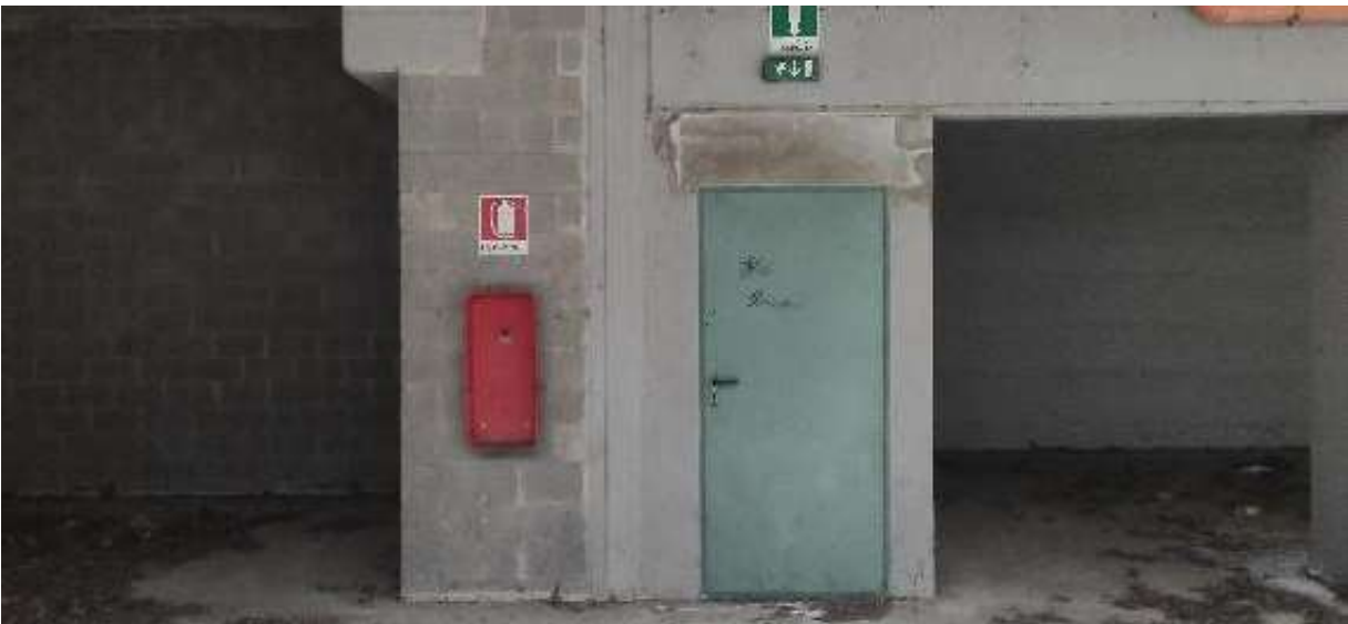
Ripresa delle dotazioni di prevenzione incendi presenti
