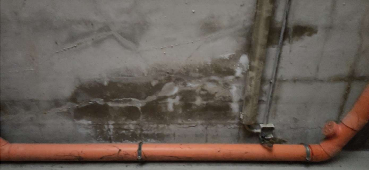
Ripresa dell'intradosso del solaio di copertura con efflorescenze dovute ad infiltrazioni di acqua piovana dall'area pubblica soprastante
